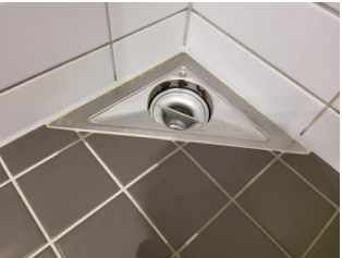
Tettesjiktets tilslutning til sluk - Sluk
