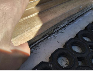
Ytterdører og omramming - Råteskade på balkongdør
