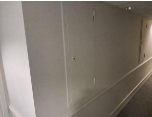
Fordelerskap og fordelerstammer - Fordelerskap for leilighet 411
