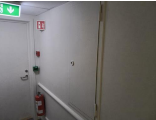
Fordelerskap og fordelerstammer - Fordelerskap for leilighet 415
