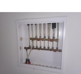
Fordelerskap og fordelerstammer - Fordelerskap for rør-i-rør-system
