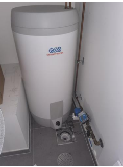
Innvendig stoppekran - Varmtvannsbereder, stoppekran og sluk
