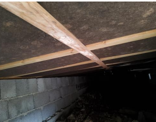
Synlige konstruksjoner - Fuktmerker
