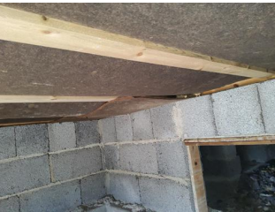
Synlige konstruksjoner - Nedbøyning i asfaltplater
