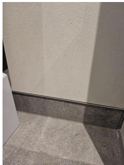
Overflater vegger - Ikke fuget i overgang sokkellist/ plater i dusjsonen
