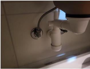
Sanitærutstyr og innredning - Røropplegg i innredning
