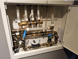
Fordelerskap og fordelerstammer - Fordelerskap og stoppekraner
