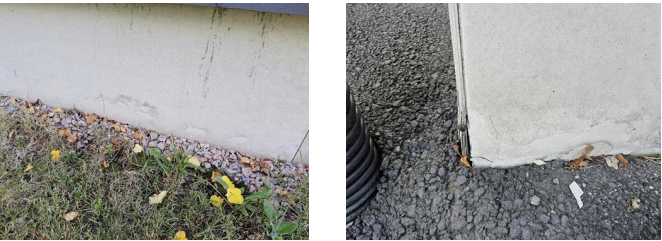
Grunnmur og fundament - - Grunnmur og fundament - Slitasje på grunnmursplater, her ved hjørne
