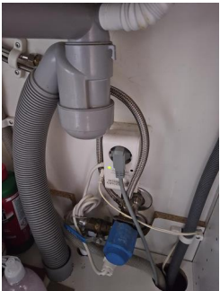
Innredning - Røropplegg i kjøkkenbenk
