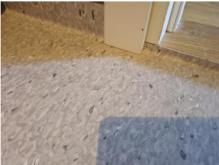
Lekkasjesikkerhet - Oppkant på belegget ved terskel
