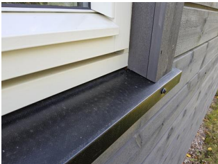
Vinduer og omramming - Liten klaring til vannbrett
