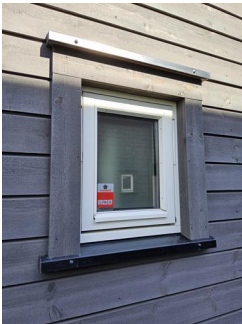
Vinduer og omramming - Ikke klaring mellom sidebelistning og vannbrett
