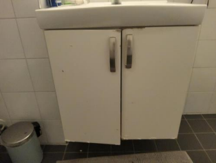
Sanitærutstyr og innredning - Svelleskader på innredning.
