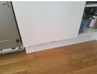
Innredning - Eksempel på skader på innredning.
