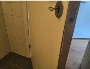
Innerdører - Eksempel på skader i dør.
