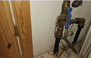
Innvendig stoppekran - Stoppekran.
