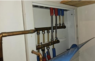
Fordelerskap og fordelerstammer - Fordelerskap
