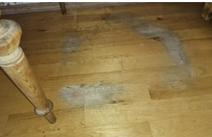
Overflate gulv - Misfarging/slitasje på gulv.
