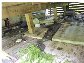
Konstruksjon og fundamenter - Utilstrekkelig fundamentering
