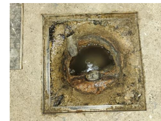
Avløp (inkl. sluk) - Sluk vaskerom
