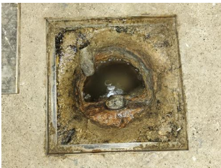
Avløp (inkl. sluk) - Sluk vaskerom
