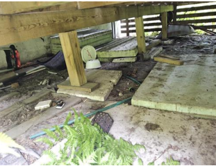
Konstruksjon og fundamenter - Utilstrekkelig fundamentering
