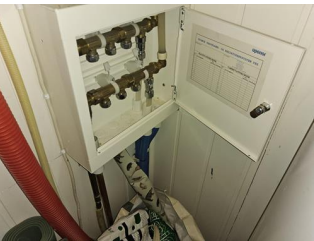
Fordelerskap og fordelerstammer - Fordelerskap for rør-i-rør-systemet
