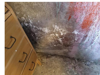
Overflate vegg - Kalk/saltutslag på vegger
