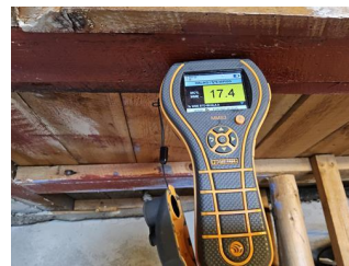
Kontroll i lukkede konstruksjoner ikke utført - Fuktmåling i kjeller med tilkomst fra plenarealer
