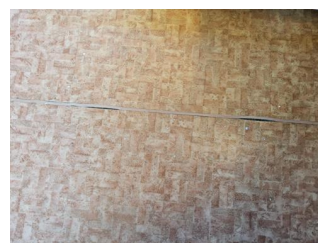
Overflater gulv - Sprekker/glipper i gulvbelegg
