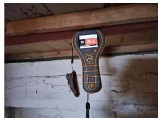
Kontroll i lukkede konstruksjoner ikke utført - Fuktmåling i kjeller med tilkomst under terrasse
