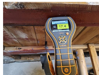
Kontroll i lukkede konstruksjoner ikke utført - Fuktmåling i kjeller med tilkomst fra plenarealer
