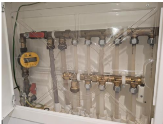
Fordelerskap og fordelerstammer - Fordelerskap for rør-i-rør-systemet
