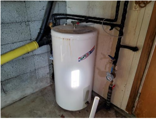
Varmtvannsbereder - Varmtvannsbereder fra 1998
