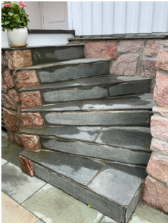
Noe bratt, manglende håndløper
