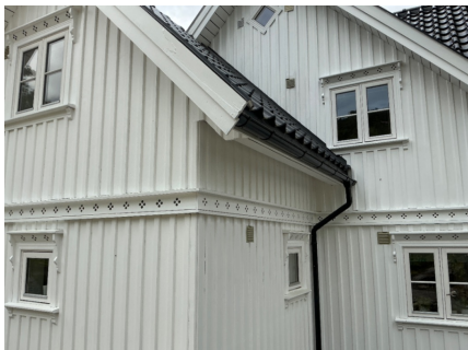
Noe begrenset lufting mellom kledning og vannbrett
