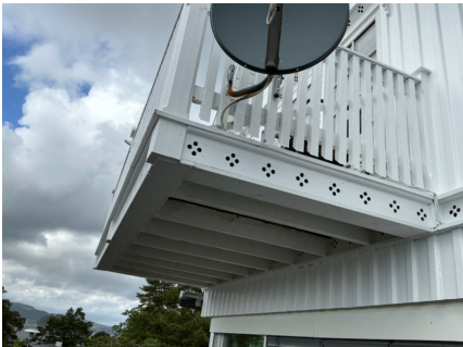
Noe avflassing av maling mm.
