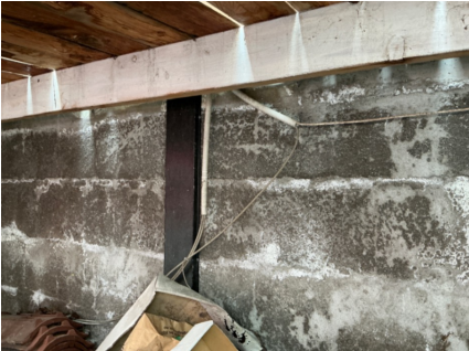
Synlig leca, upusset, saltutslag
