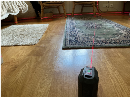
Nivellering soverom 2 etasje, avvik ca. 10-20 mm
