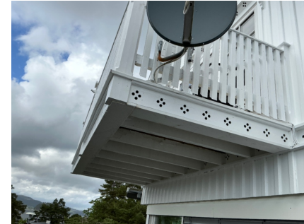
Noe avflassing av maling mm.
