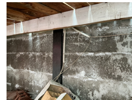
Synlig leca, upusset, saltutslag
