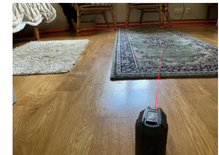
Nivellering soverom 2 etasje, avvik ca. 10-20 mm
