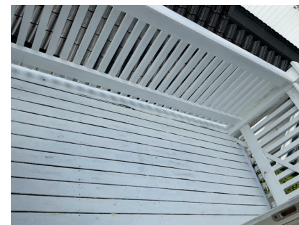
Balkong på ca. 3,3 kvm., råteskader i konstruksjonen, malte terrassebord.
