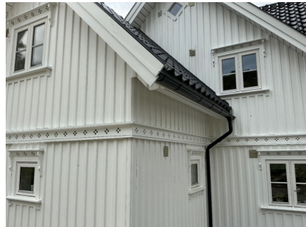
Noe begrenset lufting mellom kledning og vannbrett
