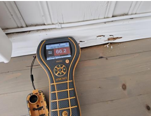
Overflate vegg - Fuktmåling i vegg
