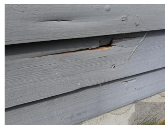
Ytterkledning (fasademateriale, vannbord, utvendig listverk, o.l.) - Råteskadet ytterkledning
