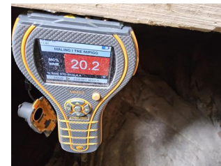
Stikktaking i treverk, fukt og fuktmålinger - Fuktmåling i krypkjeller under kjøkken
