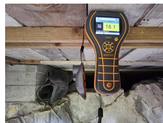
Stikktaking i treverk, fukt og fuktmålinger - Fuktmåling i krypkjeller med luke i grunnmur
