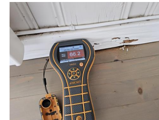
Overflate vegg - Fuktmåling i vegg
