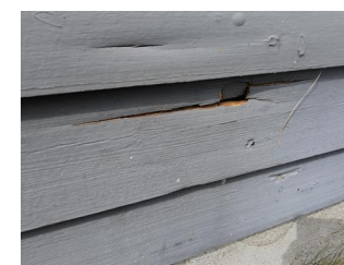
Ytterkledning (fasademateriale, vannbord, utvendig listverk, o.l.) - Råteskadet ytterkledning
