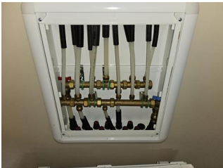
Fordelerskap og fordelerstammer - Fordelerskap for rør-i-rør-systemet
