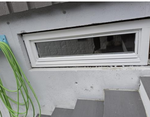
Vinduer og omramming - Ikke tilstrekkelig tetting/omramming rundt vindu
