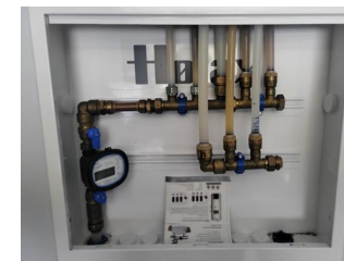
Fordelerskap og fordelerstammer - Fordelerskap for rør-i-rør system
