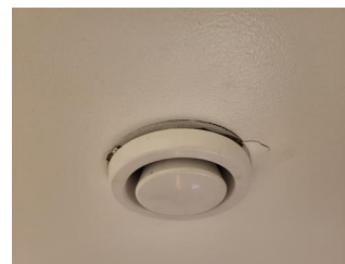
Overflater himling - Skade ved avtrekksventil
