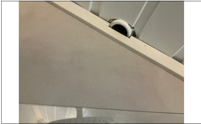
Ukjent åpent rør i himling på bad, bør sjekkes ytterligere.
