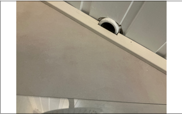
Ukjent åpent rør i himling på bad, bør sjekkes ytterligere.
