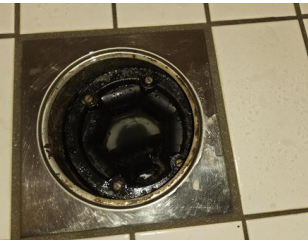
Avløp (inkl. sluk) - Sluk bad 1 underetasje
