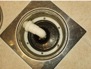
Avløp (inkl. sluk) - Sluk bad 1. etasje
