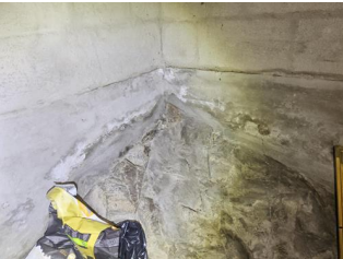
Overflate vegg - Kalk/saltutslag på vegger i bod underetasje
