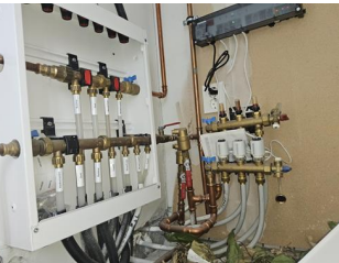
Fordelerskap og fordelerstammer
