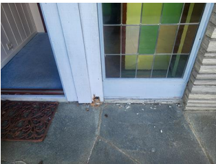
Ytterkledning (fasademateriale, vannbord, utvendig listverk, o.l.) - Råteskade
