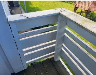
Tilstand på rekkverk og overflatematerialer - Råteskadet rekkverk
