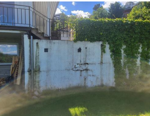
Grunnmur og fundament - Sprekker i mur til bod under terrassen
