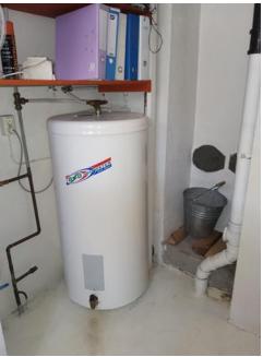
Varmtvannsbereder - Varmtvannsbereder og stakeluke
