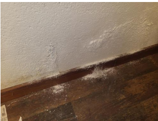
Overflate vegg - Bobler i maling og saltutslag
