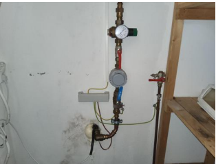
Innvendig stoppekran - Stoppekran og vannmåler
