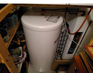
Varmtvannsbereder - Varmtvannsbereder fra 1996
