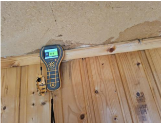
Innvendige forhold - Fuktmåling i himling
