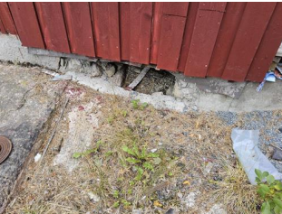
Inspeksjonsmulighet - Utilstrekkelig tilkomst grunnet lav høyde mellom bakkeplan og konstruksjoner
