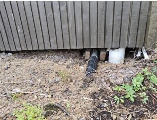
Inspeksjonsmulighet - Ingen tilkomst eller undersøkelsesmulighet på del av krypekjeller under dusjrom og toalettrom
