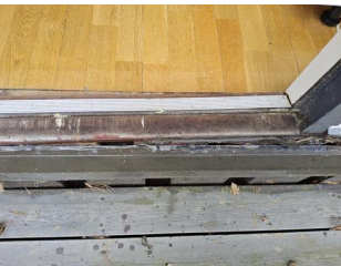
Ytterdører og omramming - Åpning/glippe mellom beslag og terskel på balkongdør
