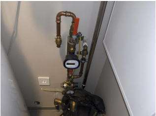
Innvendig stoppekran - Hovedstoppekran
