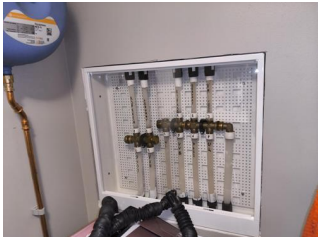
Fordelerskap og fordelerstammer - Fordelerskap
