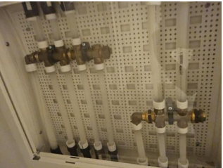
Fordelerskap og fordelerstammer - .
