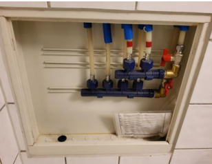
Fordelerskap og fordelerstammer - Fordelerskap
