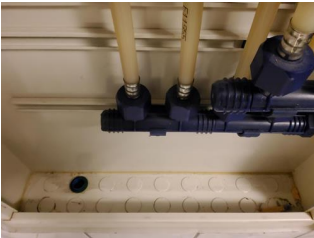
Fordelerskap og fordelerstammer - Fordelerskap
