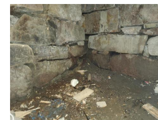
Stikktaking i treverk, fukt og fuktmålinger - Fuktinnsig
