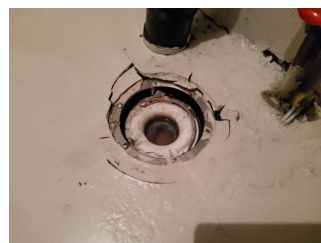
Avløprør (utover det som nevnes under andre sjekkpunkter) - Sluk
