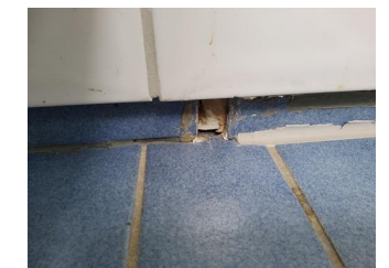
Vanntett sjikt / membran i gulv og vegger - Hull etter tidligere innfestinger
