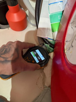
Fuktsøk innvendig vaskeskap viser tørre verdier
