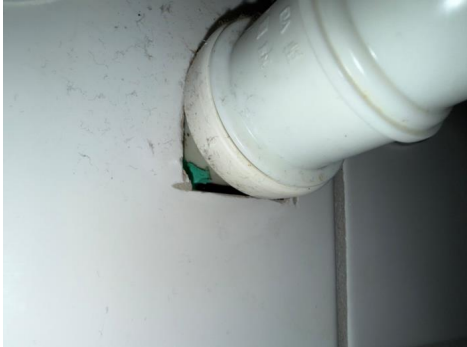
Mulig manglende mansjett/membran rørgjennomføringer
