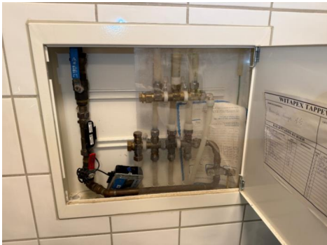
Fordelerskap på bad
