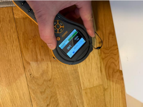
Fuktsøk gulv utenfor vaskeskap og oppvaskmaskin viser tørre verdier
