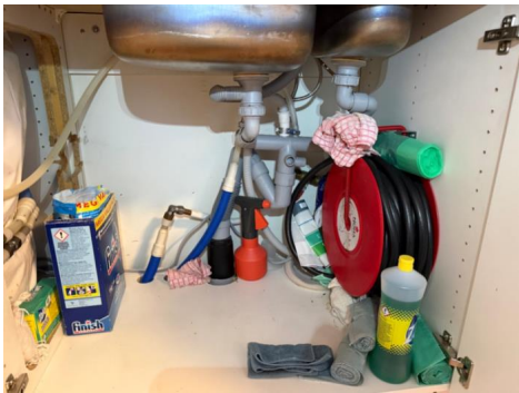
Brannslange i kjøkkenskap
