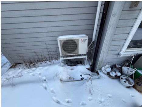
Luft-til-luft varmepumpe utedel
