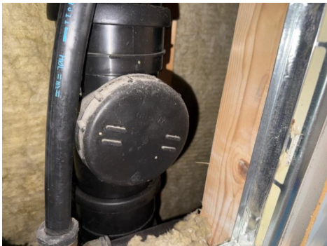
Avløpsrør og stakeluke i sjakt mellom kjøkken og bad.
