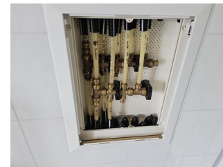
Fordelerskap og fordelerstammer - Fordelerskap for rør-i-rør-system bad/vaskerom
