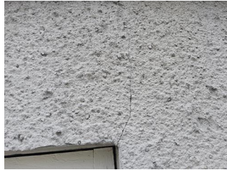
Grunnmur og fundament - Riss/sprekk i grunnmur
