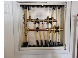
Fordelerskap og fordelerstammer - Fordelerskap for rør-i-rør-systemet teknisk rom
