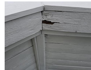
Tilstand på rekkverk og overflatematerialer - Råteskade på rekkverk
