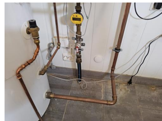
Vannrør (utover det som nevnes under andre sjekkpunkter) - Vanninntaksrør med hovedstoppekrane
