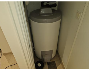
Varmtvannsbereder - Plassert i bod leilighet.
