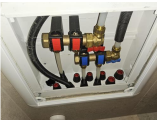
Fordelerskap og fordelerstammer - for utevann plassert på toalettrom.
