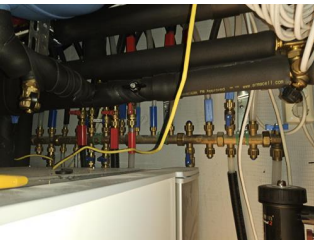
Fordelerskap og fordelerstammer - Plassert i teknisk rom.
