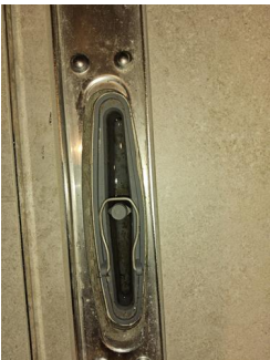
Tettesjiktets tilslutning til sluk - ved dør.
