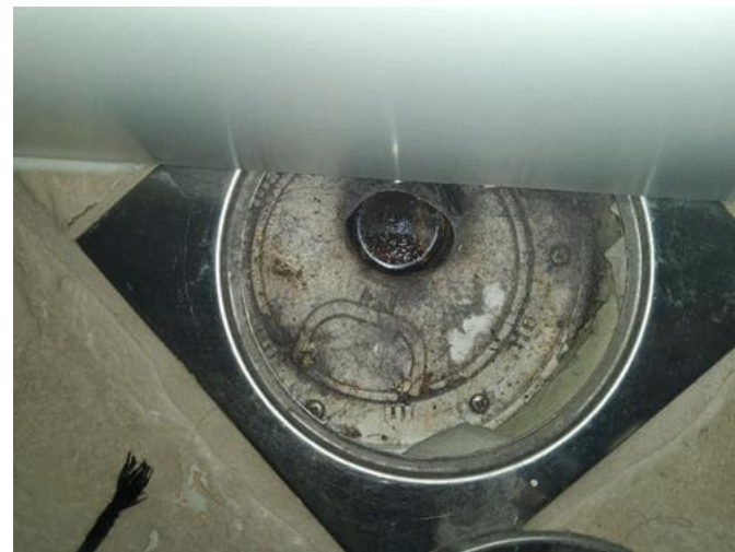
Avløpsrør (inkl. sluk) - [Hjelpesluk på bad. ]
