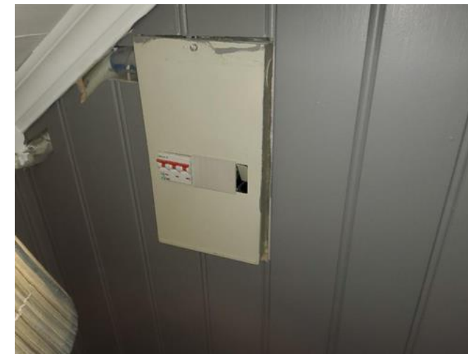
Elektrisk anlegg - [Inntakssikringer i boligen. ]
