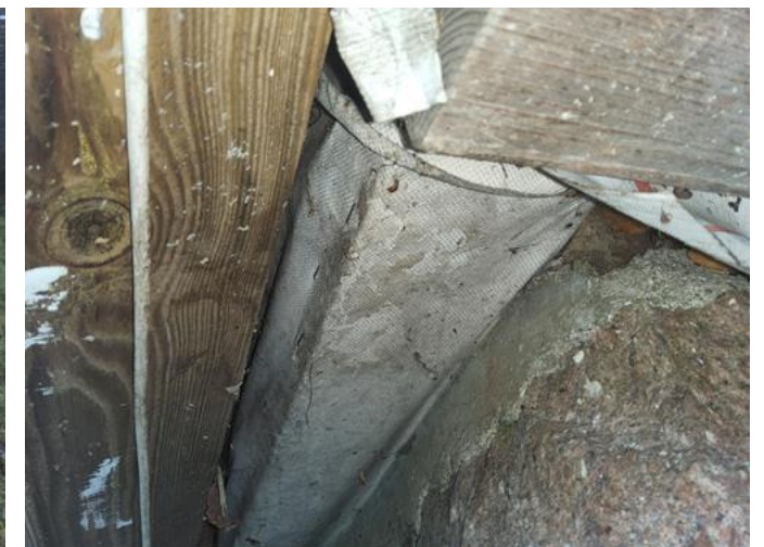
Fasader inkl. kledning - [Eksempel på kledning med mangelfull musesperre og blokkert lufting. ]
