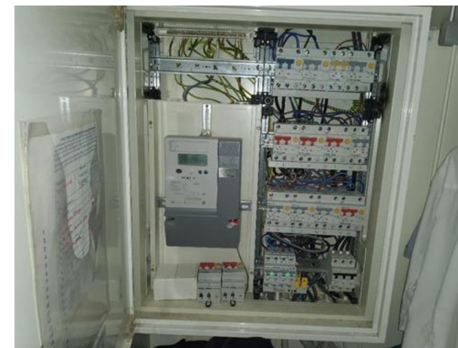
Elektrisk anlegg - [Sikringskap i boligen. ]
