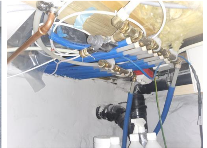
Tekniske anlegg, VVS anlegg (Sjekkpunkter utover det som er inkludert i andre rom) - [Fordelerstammer for rør-i-rør. ]
