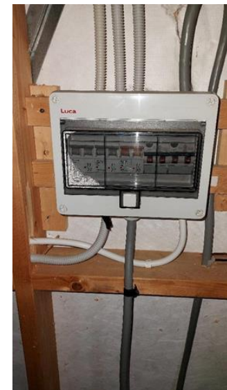
Elektrisk anlegg - [Sikringskap i garasje. ]
