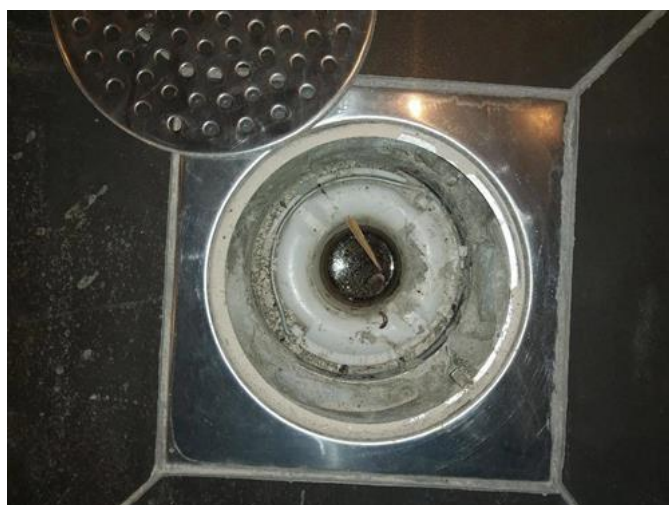
Rom under terreng (kjeller, underetasje, sokkeletasje) - [Sluk i kjeller. ]
