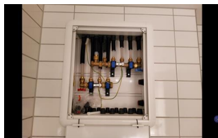
Fordelerskap og fordelerstammer - Fordelerskap for rør-i-rør-systemet
