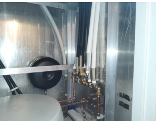
Fordelerskap og fordelerstammer - Fordelerstammer for rør-i-rør-systemet.
