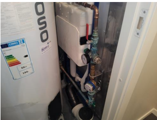
Innvendig stoppekran - Hovedstoppekran og vannmåler.
