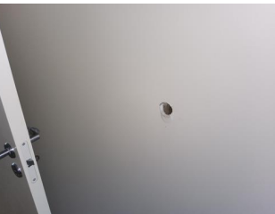
Overflate vegg - Skade i vegg på soverom 2.
