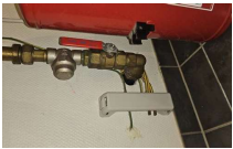
Innvendig stoppekran - Stoppekran.
