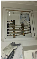
Fordelrørskap og fordelerstammer - Fordelrørskap.
