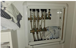
Fordelerskap og fordelerstammer - Fordelerskap.
