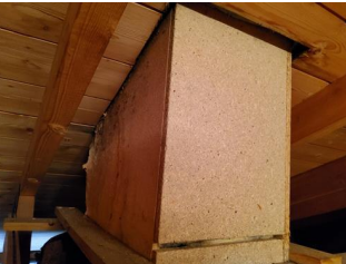
Synlige overflater (taktro, vegger, gulv, o.l) - Fuktmerker
