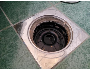
Tettesjiktets tilslutning til sluk - Sluk
