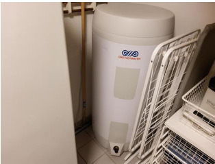
Varmtvannsbereder - Varmtvannsbereder fra 2021
