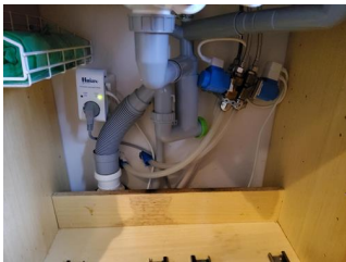
Vannrør - Røropplegg i benkeskap
