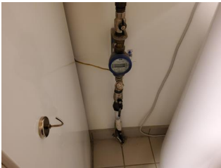
Varmtvannsbereder - Vanninntaksrør og hovedstoppekran
