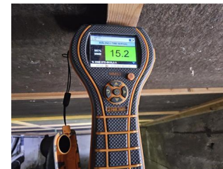
Stikktaking i treverk, fukt og fuktmålinger - Fuktmåling
