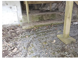
Konstruksjon og fundamenter - Ufagmessig utførelse på fundamenter
