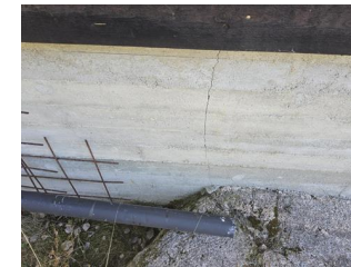
Grunnmur og fundament - Sprekk i grunnmur
