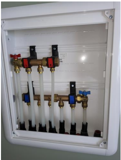
Fordelerskap og fordelerstammer - Fordelerskap
