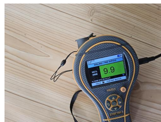
Overflate gulv - Fuktmåling i gulv under oppvaskkum.
