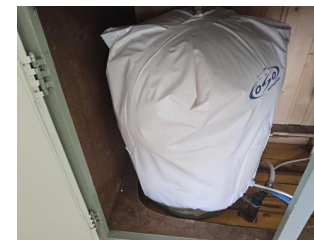
Varmtvannsbereder - Plassert under kjøkkenbenk
