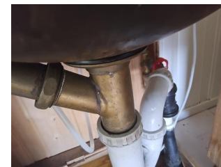
Innvendig stoppekran - Plassert i benkeskap kjøkken
