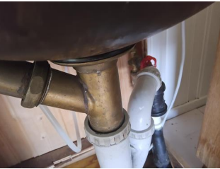
Innvendig stoppekran - Plassert i benkeskap kjøkken
