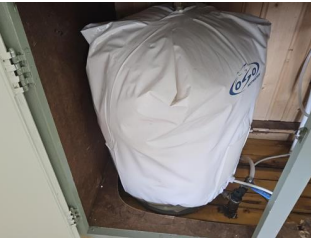
Varmtvannsbereder - Plassert under kjøkkenbenk
