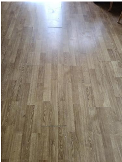
Overflate gulv - Slitasje gulv og gliper i skjøter
