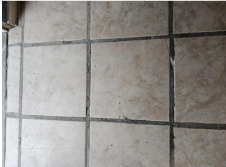
Overflate gulv - Knekte fliser i entre
