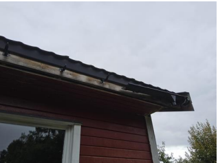
Takrenner og utvendige nedløp - Stedvis manglende takrenner
