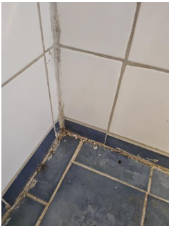
Overflater gulv - Ujevne fliser og slitasje
