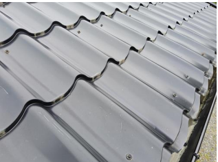
Tekking (med tilhørende beslag) - Enkelte slitasje symptomer
