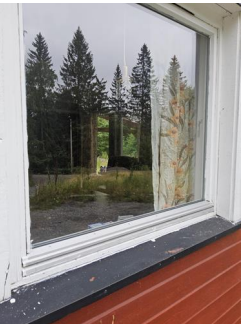
Vinduer og omramming - Slitasje på vinduer
